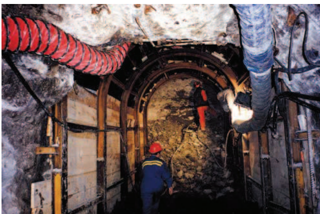
FRANCE - Métro de Lille - Ligne 2 Excavation à l'abri de la voûte congelée en direction du tunnel en construction
