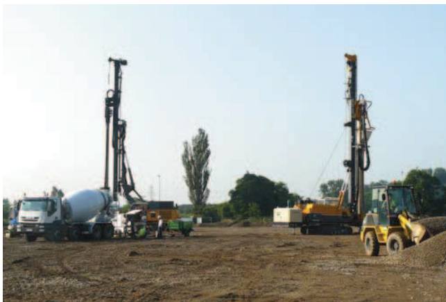
A gauche, la machine d'inclusions et à droite, la machine de colonnes ballastées
