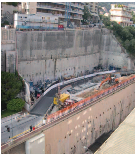
MONACO - Testimonio (2004 - 2005) Paroi berlinoise, béton projeté, paroi moulée, tirants provisoires et permanents
